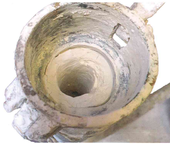
Abb. 3 // Extremfall von Schichtaufbau innerhalb einer Rohrleitung infolge unzureichender Reinigung; die Schicht bietet zu jedem Zeitpunkt die besten Bedingungen für Mikroorganismen zum Überleben und sich vermehren; ein kontinuierlicher Keimeintrag in durchfließende Produkte ist in diesem Zustand, trotz Spülen mit einer Biozidlösung, nicht mehr zu vermeiden.
